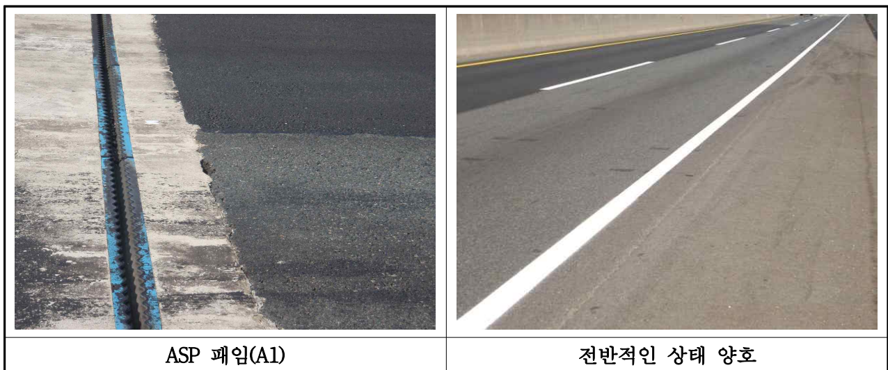
【사진 3.2.16】 교면포장 손상현황(대구)
