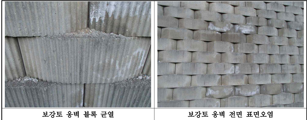
【사진 3.3.22】 기타 시설 손상현황(부산)
