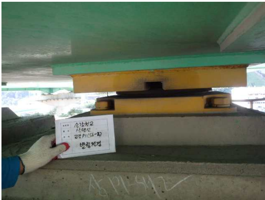
받침장치 전경 (가동단)
