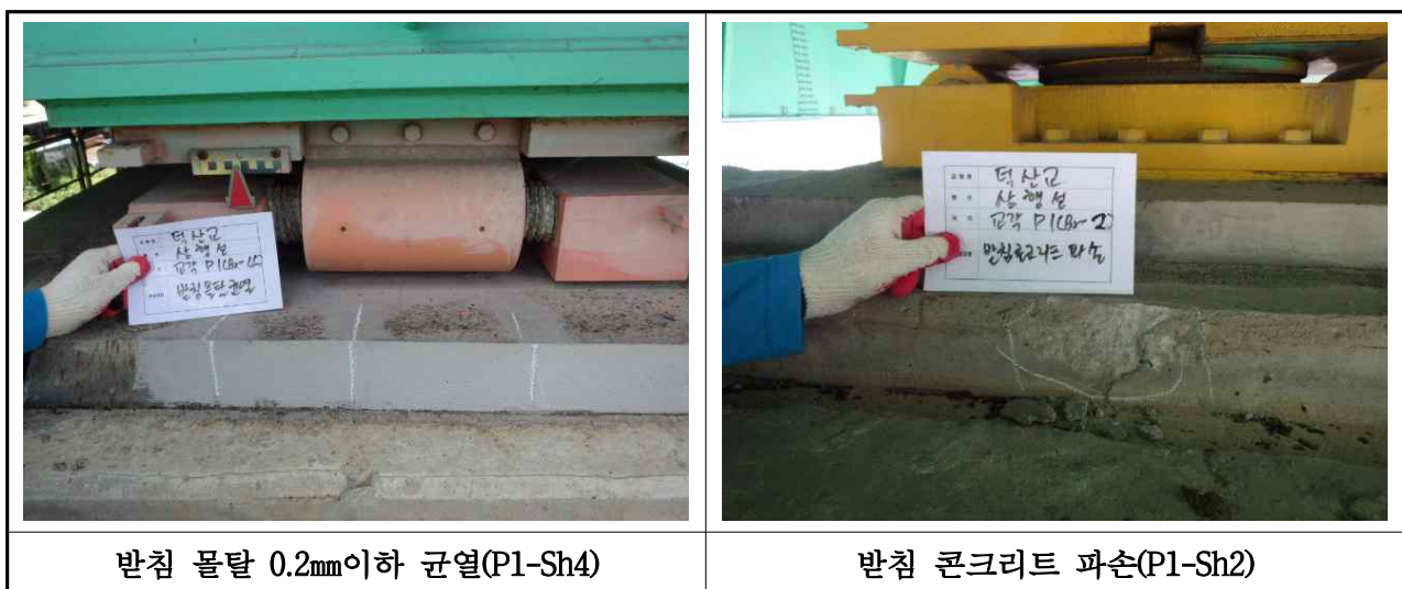
【사진 3.2.11】 교량받침 손상현황(대구)
