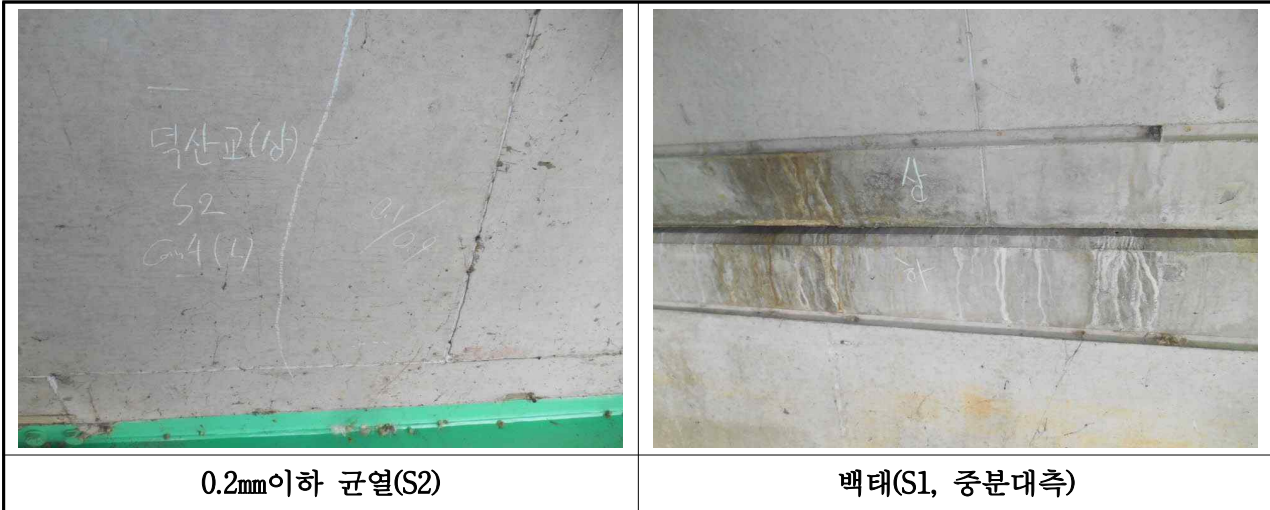
【사진 3.2.2】 바닥판 손상현황(대구)
