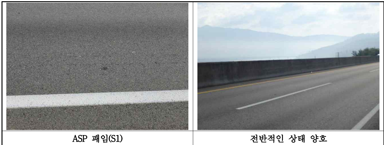
【사진 3.3.17】 교면포장 손상현황(부산)
