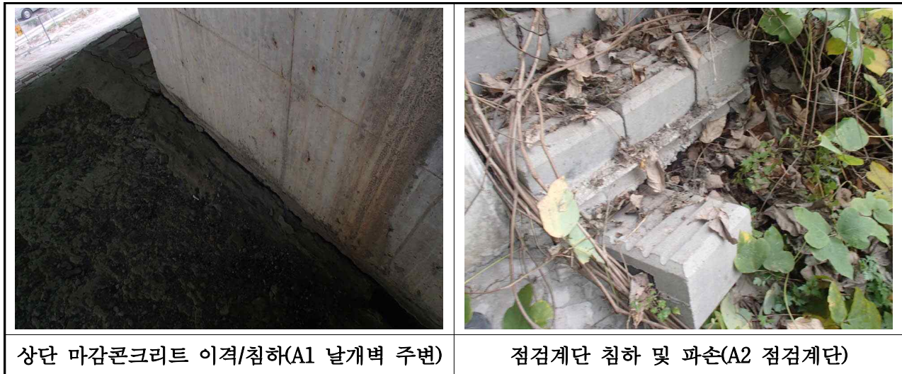
【사진 3.2.7】 교대 손상현황(대구, 계속)
