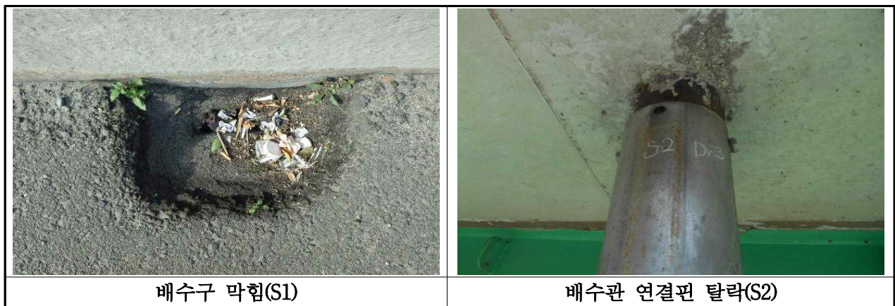
【사진 3.3.19】 배수시설 손상현황(부산)
