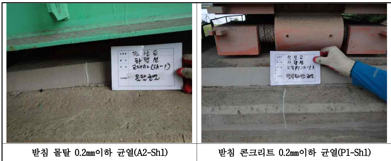
【사진 3.3.12】 교량받침 손상현황(부산)
