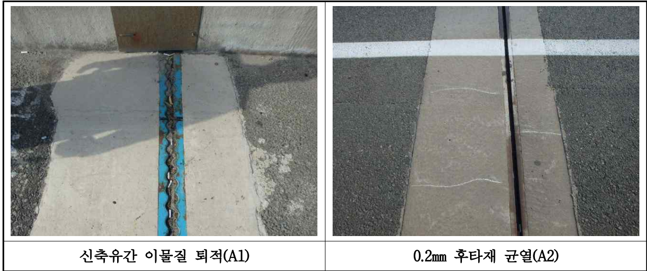
【사진 3.3.14】 신축이음장치 손상현황(부산)
