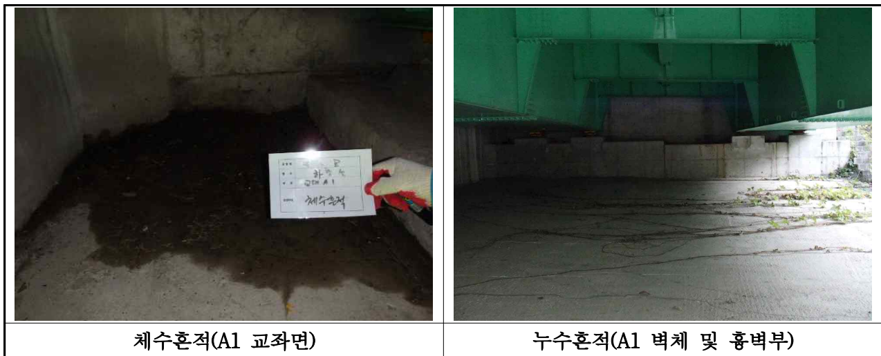
【사진 3.3.8】 교대 손상현황(부산)
