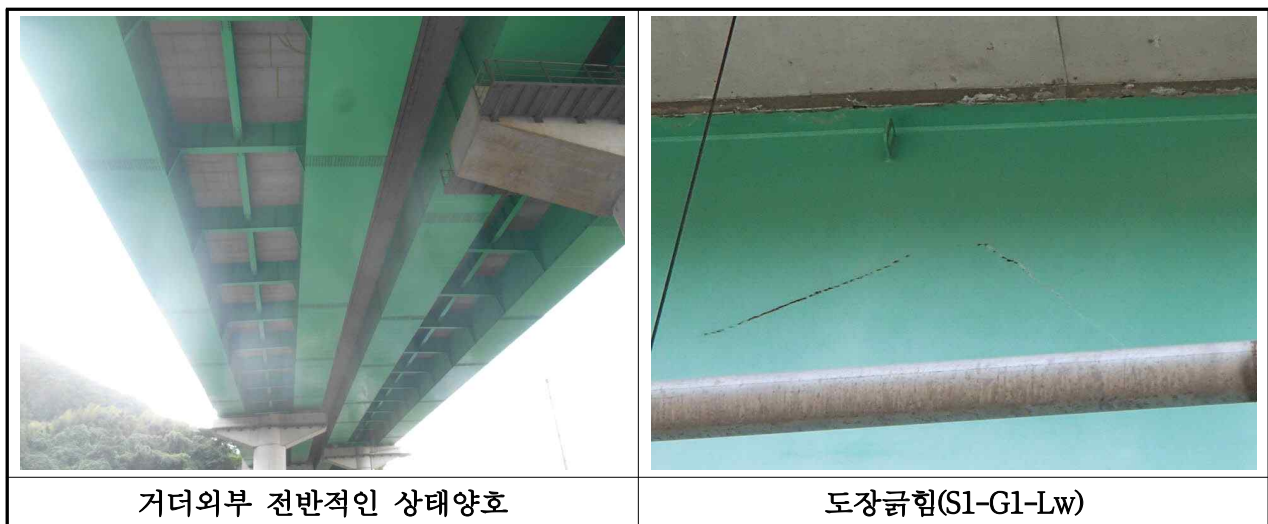
【사진 3.3.5】 강박스 거더 외부 손상현황(부산)
