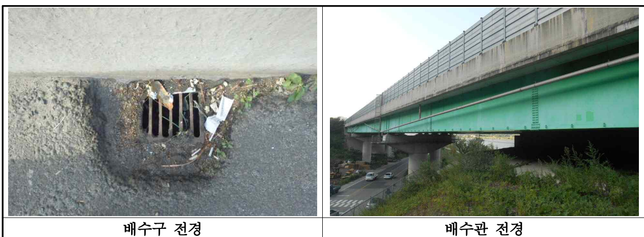
【사진 3.3.18】 배수구 및 배수관 전경(부산)
